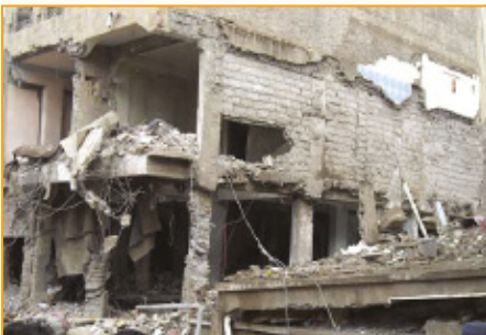
Bild 26. Zerstörtes Gebäude nach einer Explosion.
