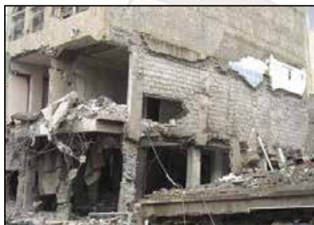
Figura 20. Esplosione di un edificio.
